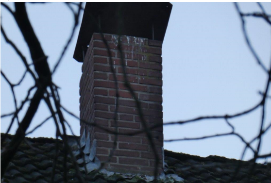
Brutplatz im Schornstein (Kotspuren)
