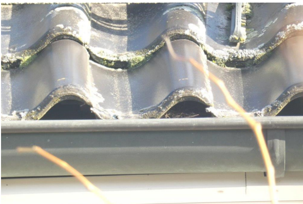
Brutplatz unter Dachpfanne
