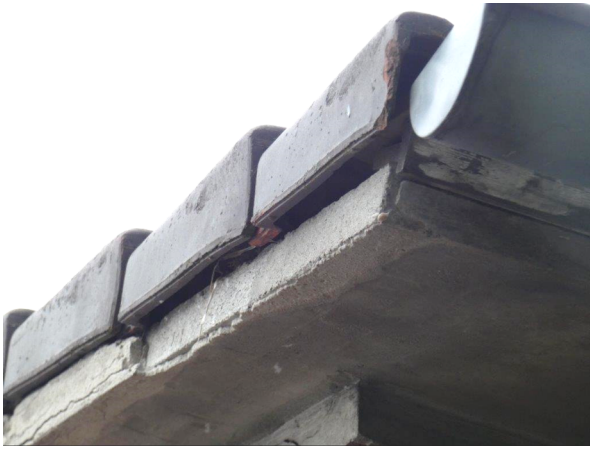
Brutplatz hinter Ortgang-Dachpfannen
