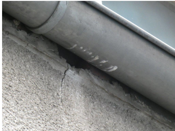
Mauersegler-Brutplatz hinter Regenrinne
