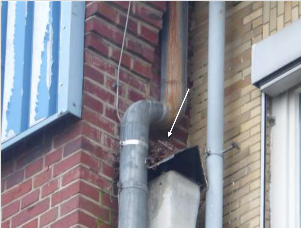
Abb. 9: Nistplatz (wahrscheinlich Ringeltaube) unterhalb eines Fallrohres (07.03.22)
