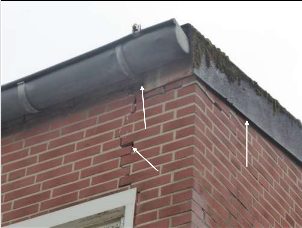
Abb. 3: Potenzielle Fledermaus-Quartiere an der Spachtelfabrik im Süden des Geltungsbereiches (16.02.22)
