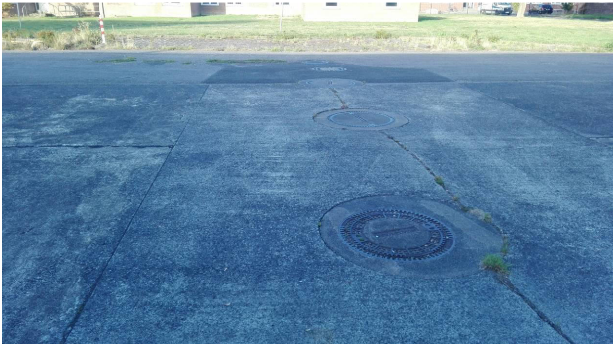
Abbildung 9: Abscheideranlage; Gebäude Nr. 10
