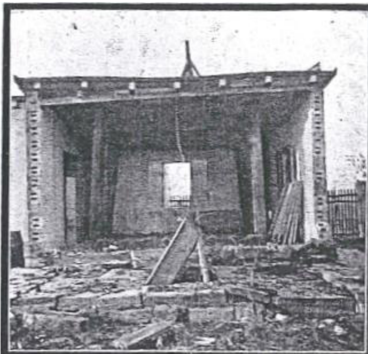
Abbildung 3: Ruine eines Arbeitsschuppens in der Munitionsanstalt /2/
